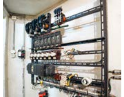
Ancienne commande d'ascenseur.
