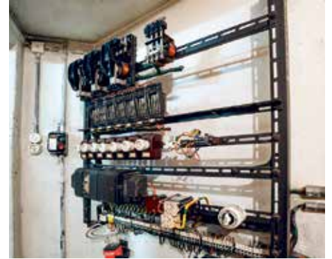
Ancienne commande d'ascenseur.
