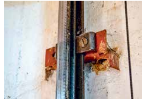
Les anciens rails de guidage – ici avant la rénovation – ont une durée de vie presque illimitée.
