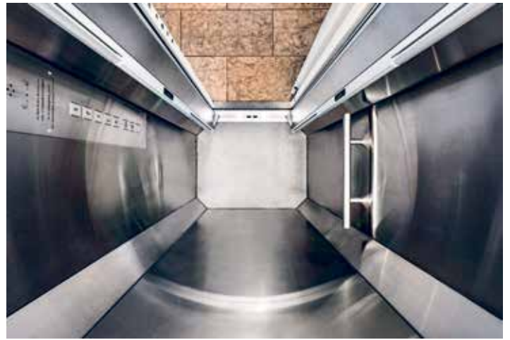
Dank den abgeschrägten Ecken und der Falttür fügt sich die neue Kabine ohne Platzverlust in den kreisrunden Schacht.
