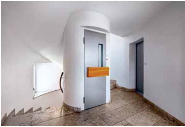
Von aussen sieht er aus wie immer: der modernisierte Lift.
