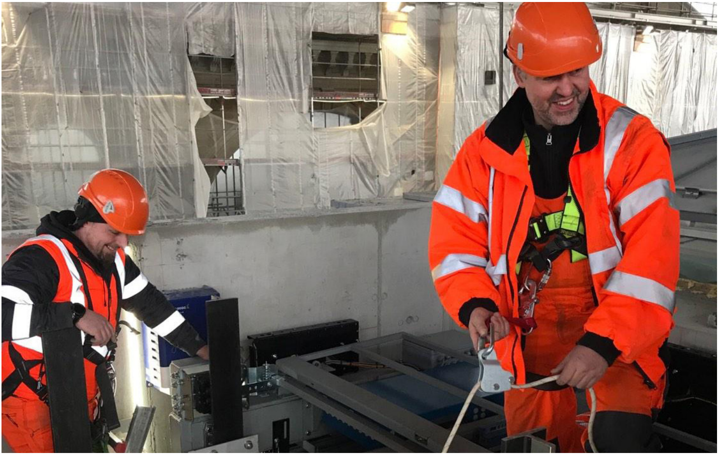
Montage de l'ascenseur dans l'aile sud de la gare principale de Zurich
