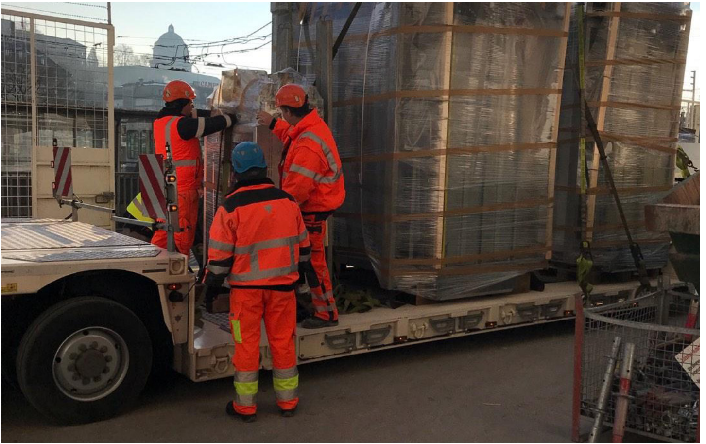
Montage de l'ascenseur dans l'aile sud de la gare principale de Zurich
